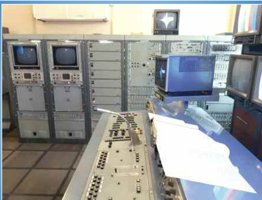
Стойки телевизионного оборудования.
